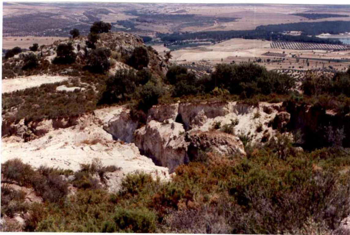
Fotografía nº 12: Cabecera del deslizamiento. Obsérvense grietas de cabecera y escarpe principal.
