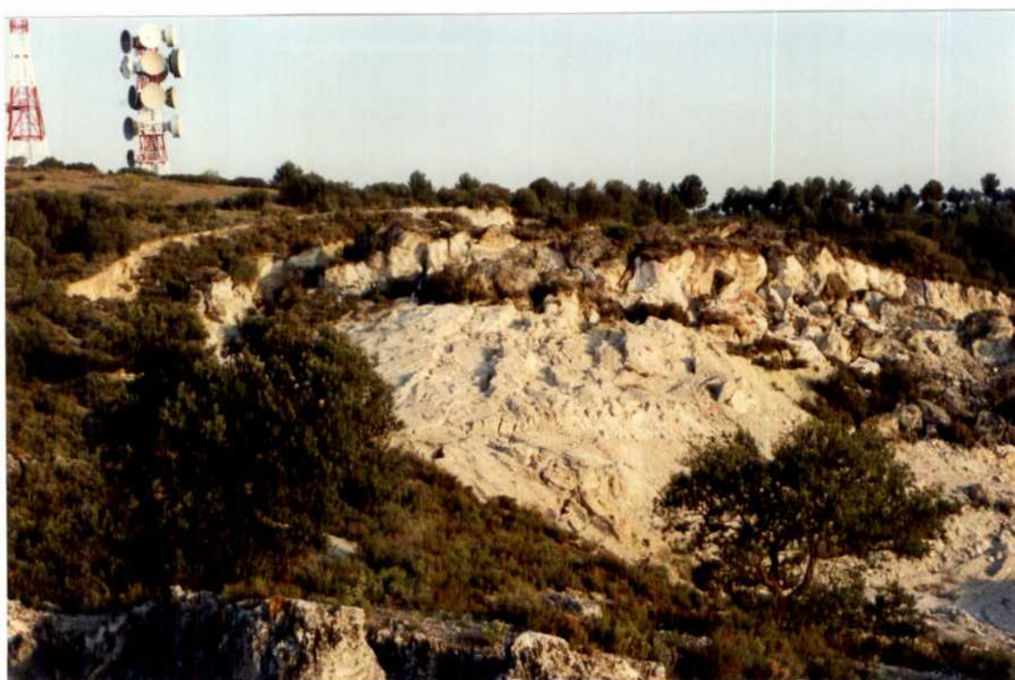
Fotografía nº 15: Cabecera del deslizamiento.
