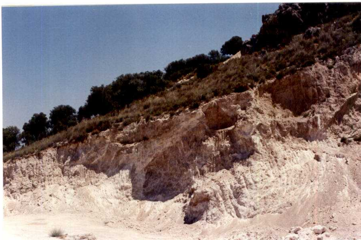
Fotografía nº 3: Materiales que han sido socavados al pie del deslizamiento.
