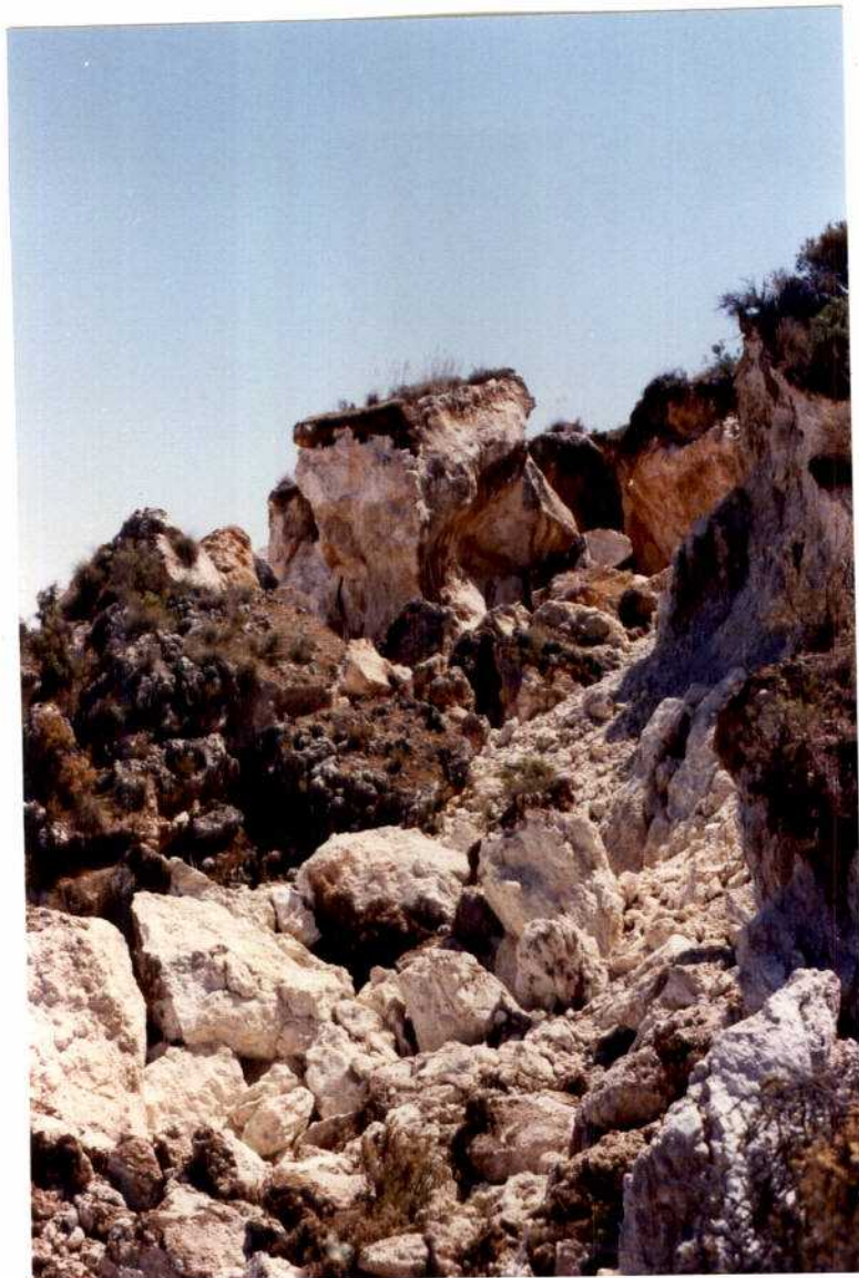
Fotografía nº 9: Agrietamiento del material situado en la parte centro-derecha del deslizamiento.
